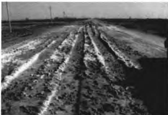
69-rasm. Yo'l poyi yuzasidagi tuzlarni ko'rinishi.
