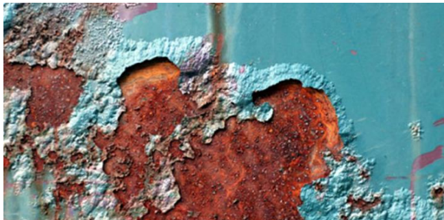
Рис.6.20. Вид разрушения органического покрытия (краски)
