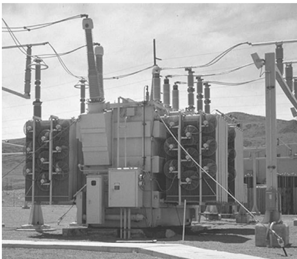
100-rasm. Pasaytiruvchi transformator
