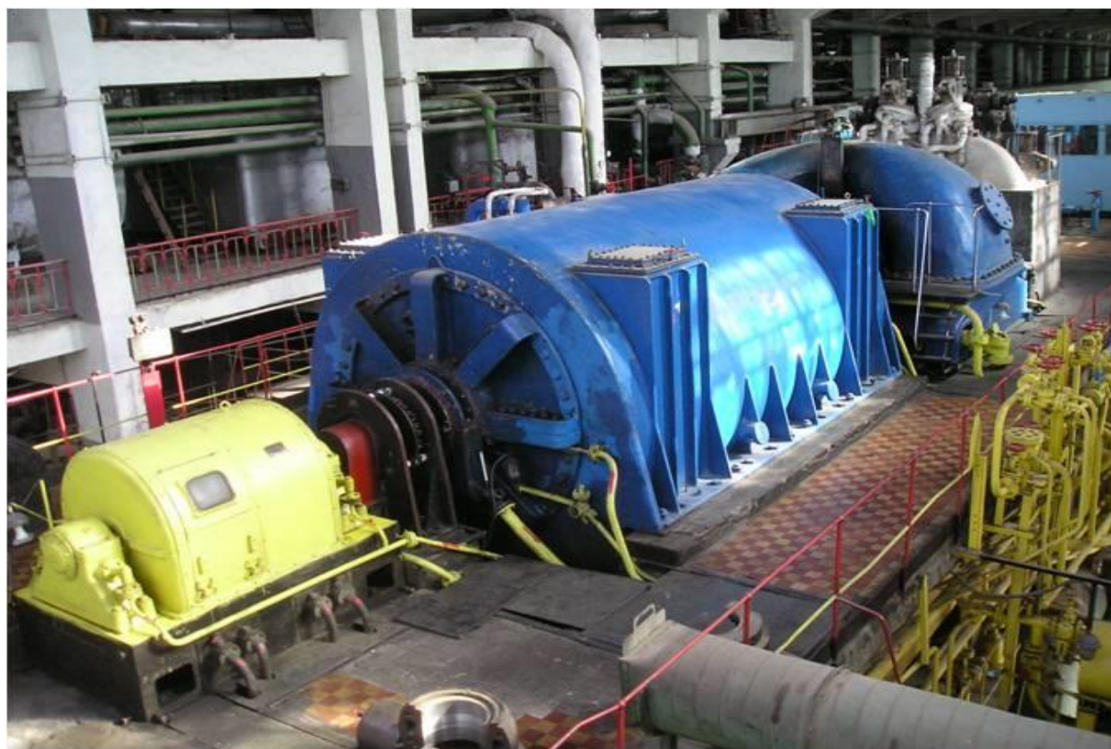
44-rasm. «Toshkent IEM» AJning gaz-turbina uskunasi
