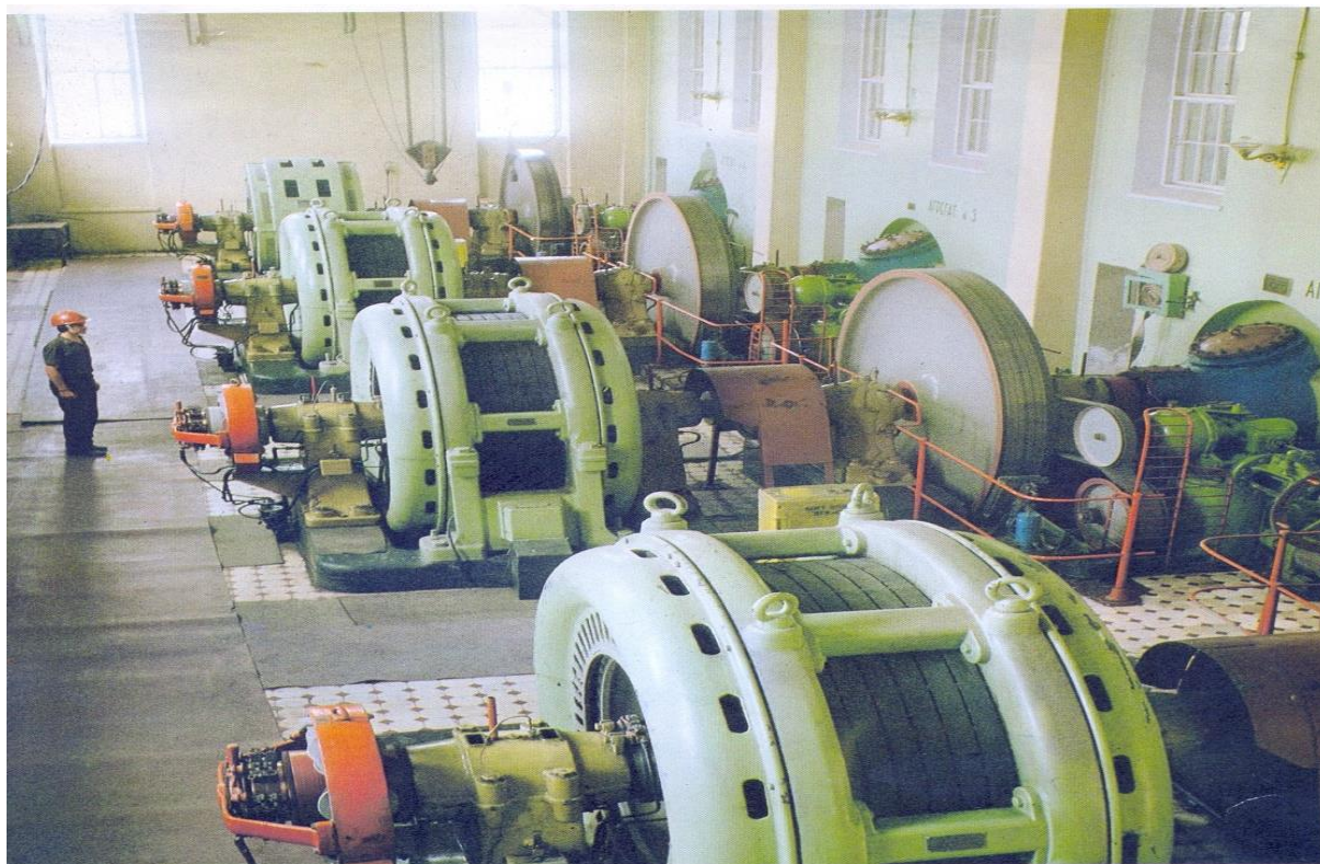
65-rasm. O‘zbekistonda eng birinchi qurilgan Bo‘zsuv GESining gidrogeneratorlar zali
