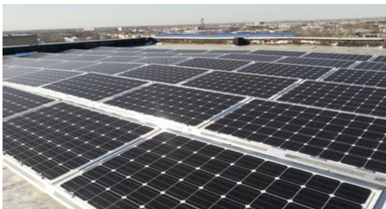
47-расм. 20 кВт қувватли қуёш фотоэлектрик станциясининг умумий кўриниши
