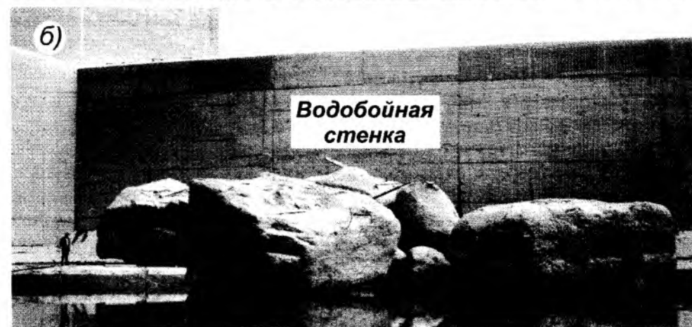
Рис. 9.6 Внешний вид разрушенного водобойного колодца Саяно-Шушенской ГЭС
