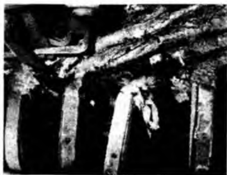
Рис. 6.31 Разрушение нижних лобовых частей обмотки статора генератора в результате междуфазного КЗ
