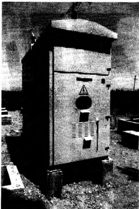
Kuchlanishi 35/04 kV li quvvati 100 kVA li transformator.
