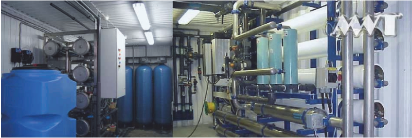
Şəkil 3.4. Mikrofiltrasiya qurğusunun ümumi görünüşü
