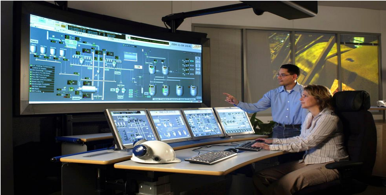
9-rasm. TJABSlarni boshqaruvchi operator ish stansiyasi
